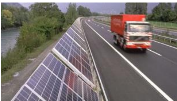
Murs antibruits couverts de panneaux solaires
