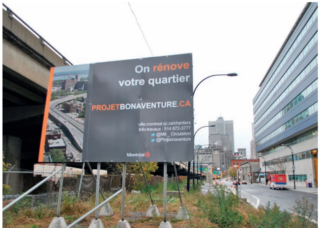
Démarrage des travaux : le Projet Bonaventure en novembre 2012 © P. Lecroart IAU îdF
