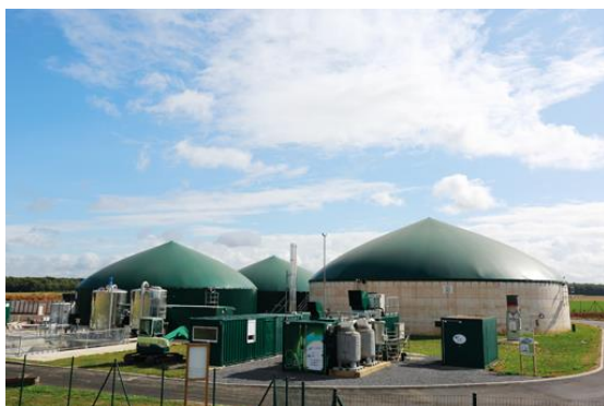
Les installations de méthanisation par injection de la Ferme d'Arcy à Chaumes-en-Brie
