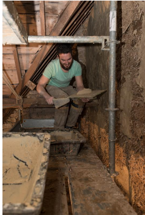
Des bénévoles, des collègues de la coopérative de bâtiment, et des amis participent au chantier de Yohann, qui durera trois jours.
