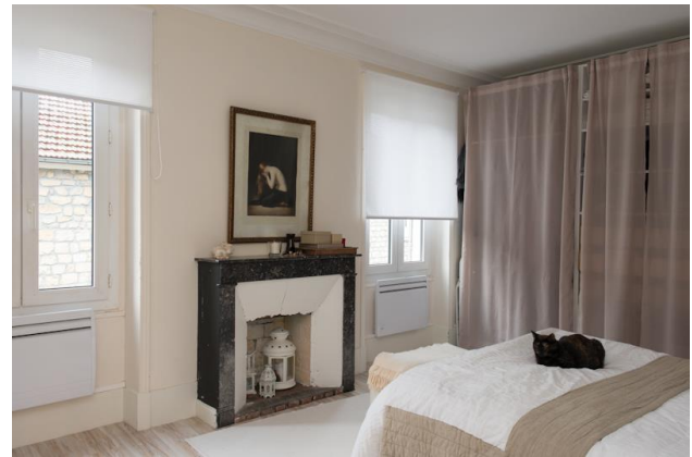
La chambre du couple a été repeinte et le sol changé mais l'absence d'isolation provoque de l'humidité sur les murs qui laissent apparaître des infiltrations.
