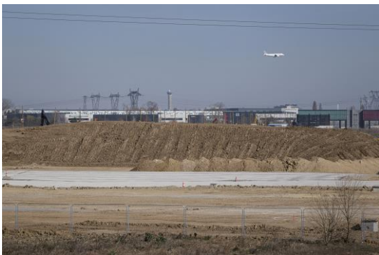
ZAC Aerolians – Aménagement de zones logistiques à proximité immédiate de l'aéroport CDG © Pierre-Yves Brunaud
