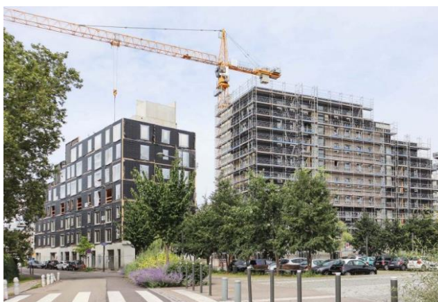
Ilot Bois – Lot 3 Prinvincis/Nouveau logement /Lucquet architectes associés– 2016-2022 Crédit photo Alienor Heil Selimanovski / L'Institut Paris Region
