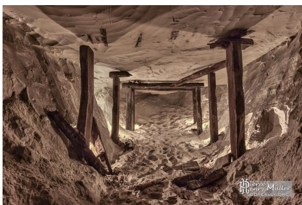
Consolidation des galeries par des madriers de bois dans la carrière de sable du Puiset
