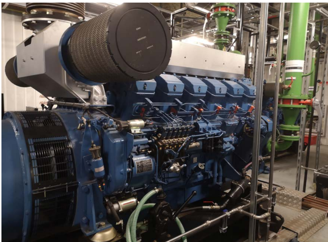
Data center DC6-IDF d'Euclède à Lognes, en Seine-et-Marne : bâtiment, baies de serveurs, équipements frigorifiques, générateur de secours. Source : L'Institut Paris Region, 2022.
